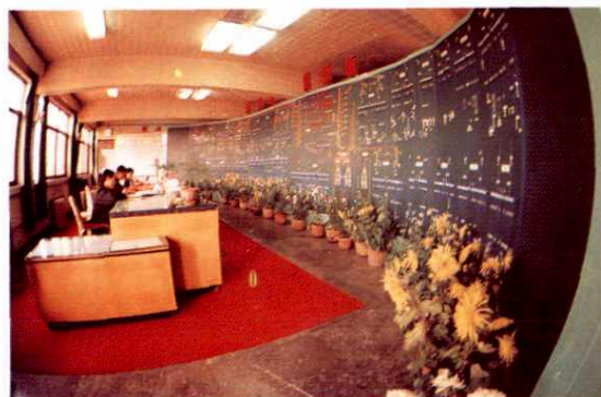
• 动力厂调度室。
