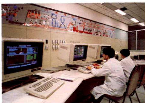
• 闪速熔炼主控制室。
