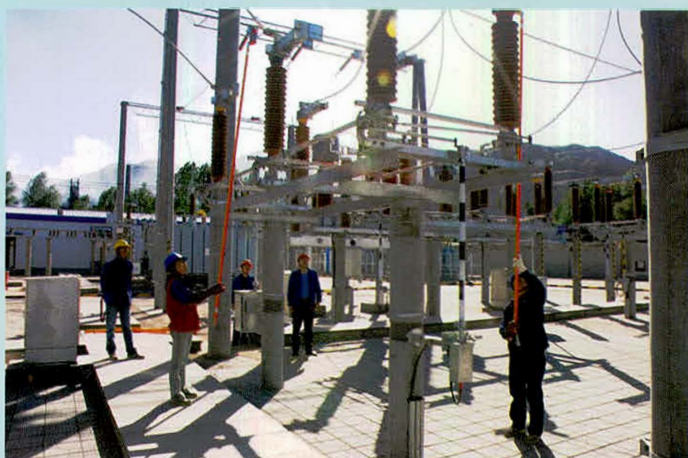
2009年5月22日 110 千伏龙口变电站竣工投运
