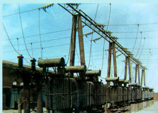
1991 年 3 月 220 千伏宁远堡变电站设备区
