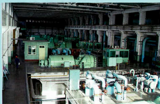
永昌发电公司 1-5 号机组全景
