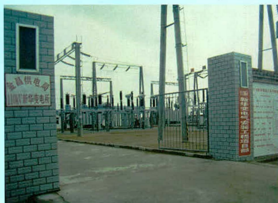
2003年 金昌供电局 110 千伏新华变电站投产
