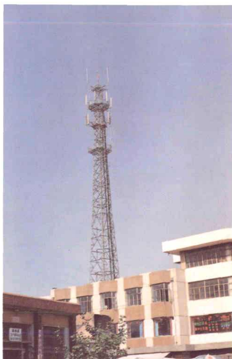
移动通讯基站铁塔
