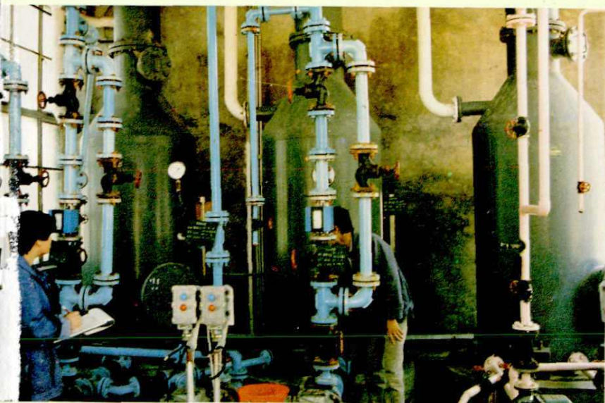
县溶解乙炔厂 净化车间
