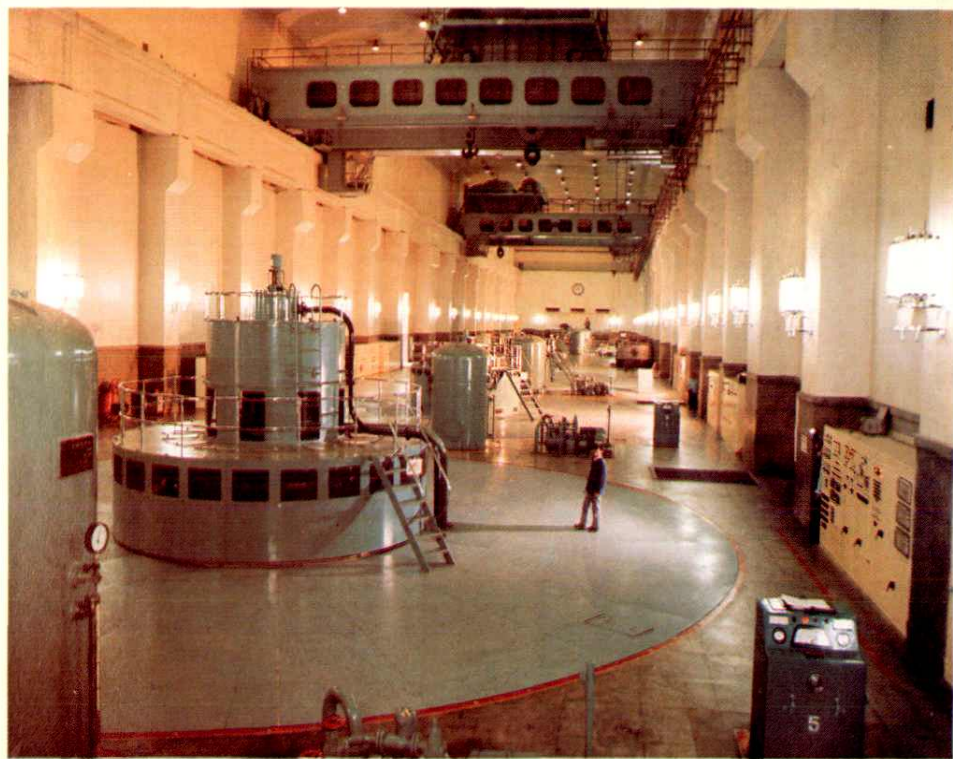
刘家峡水电厂发电机组
