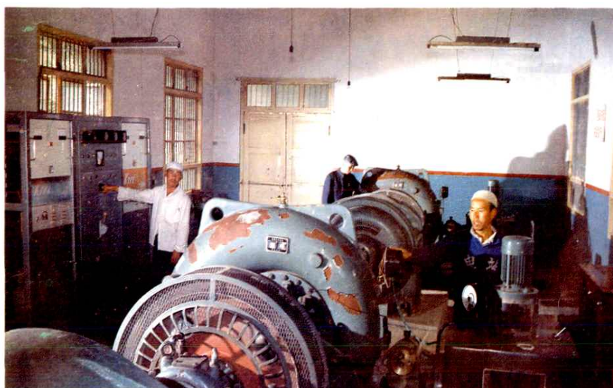
刁祁水电站一站机房
