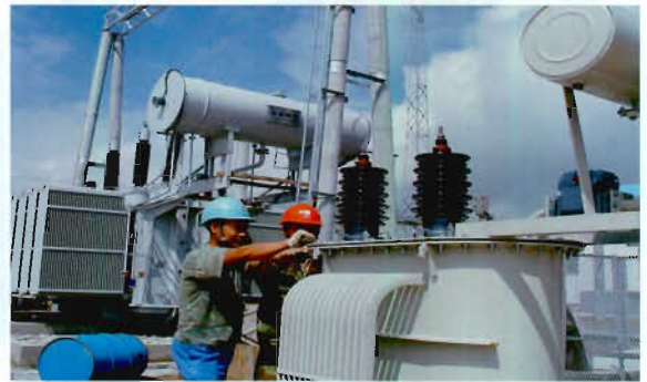
吹麻滩变电站一角
