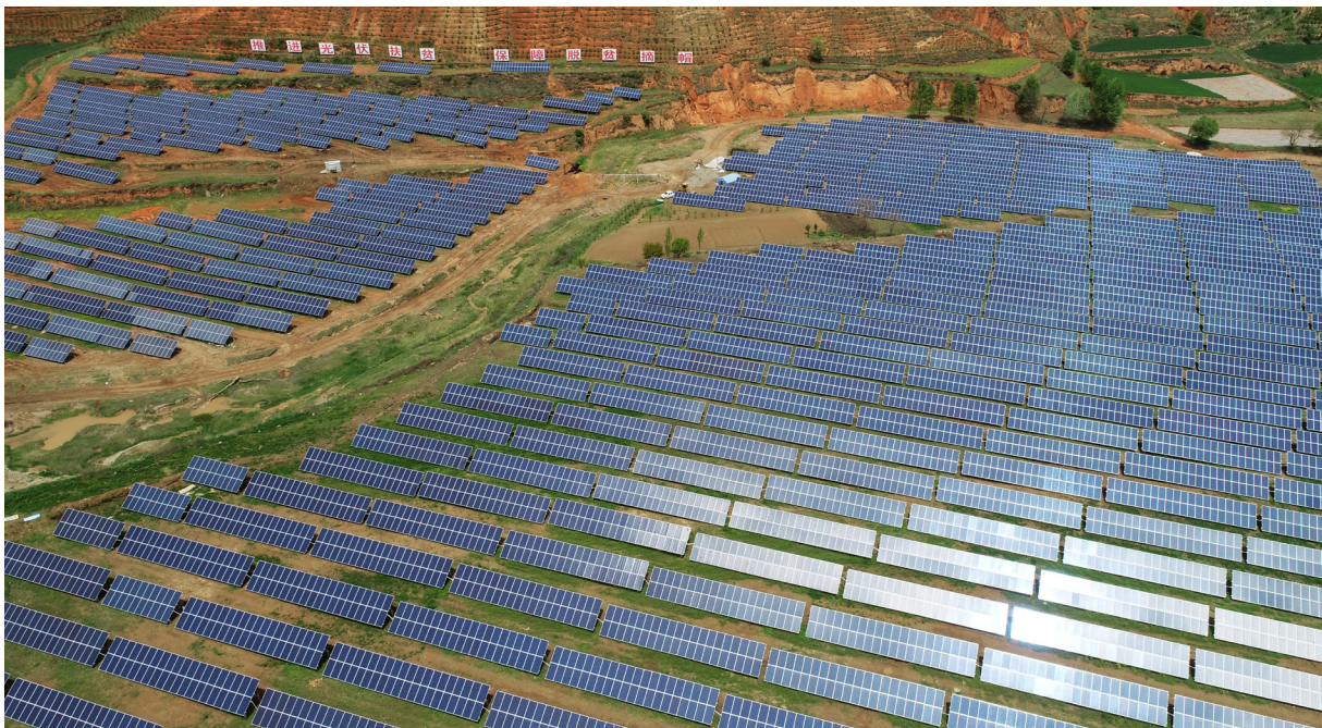
榆盘镇光伏发电
