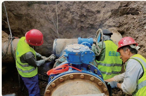
正宁县城新旧供水管网并网
