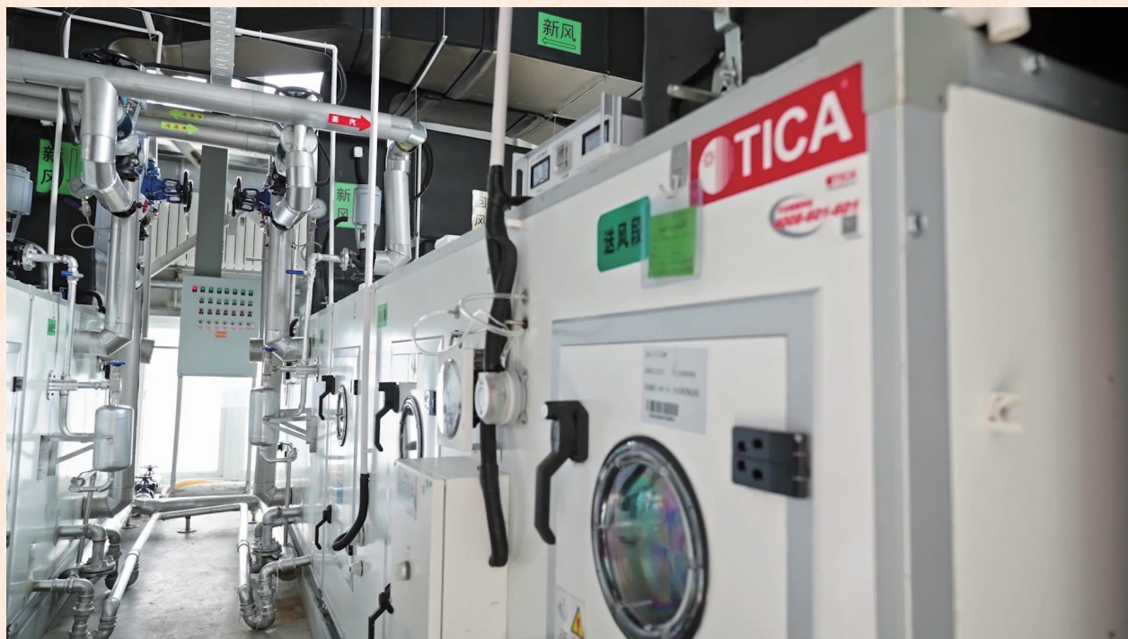
甘肃泛植制药有限公司车间设备
