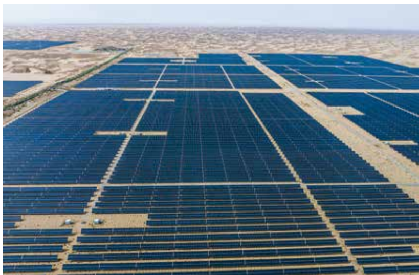
图 25 2024 年 6 月,凉州区九墩滩光伏治沙产业园 (侯得志 摄)
