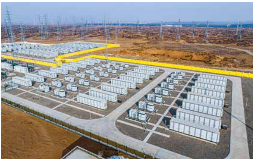
图 46 2024 年 2 月,古浪县忆恒宝华光伏电站储能电池仓 (《武威日报》采访组摄)
