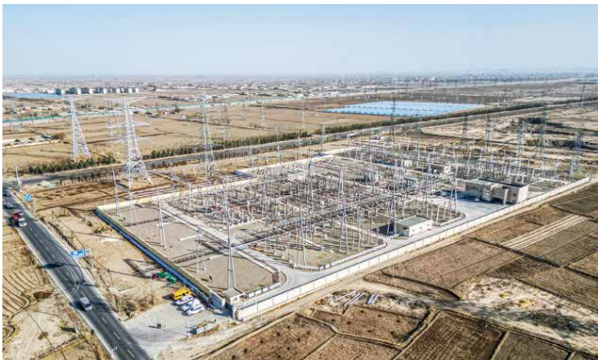
图 79 2024 年 3 月,兰张三四线外部供电工程首条 330 千伏牵引站供电线路成功投运
