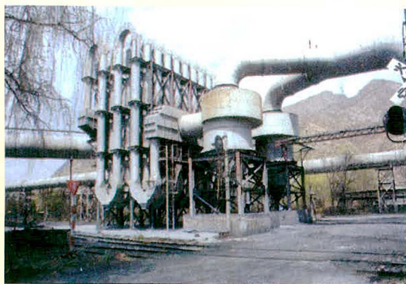
西北铁合金厂 1968 年建成的除尘设施
