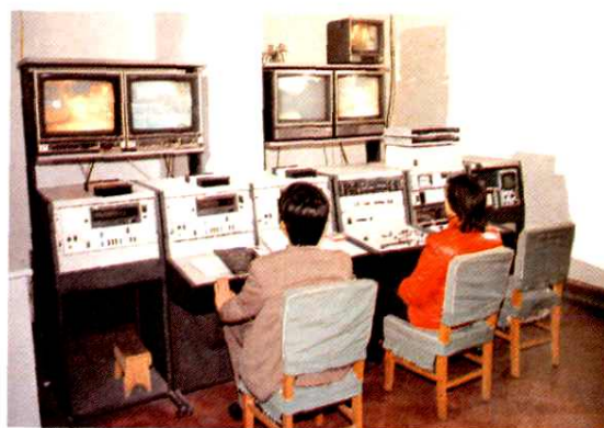
▲兰州电视台中控机房(1988年)
