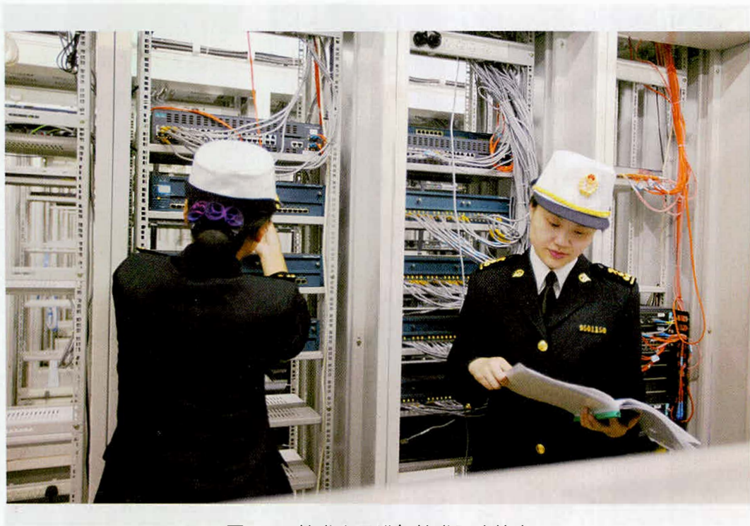
图6-4 技术人员进行技术网络检查
